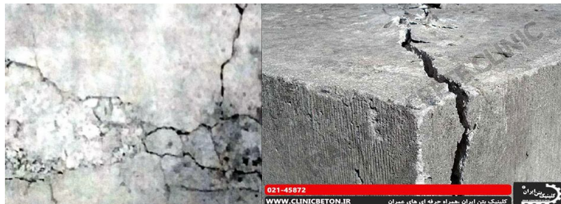
یخ زدگی عامل تخریب بتن
